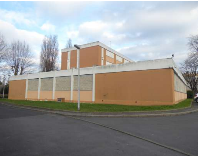
La façade Ouest de L'IFSI présentant des dégâts sanitaires
