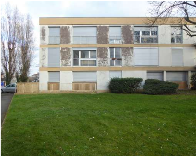
La façade Ouest des logements de fonction présentant des dégâts sanitaires
