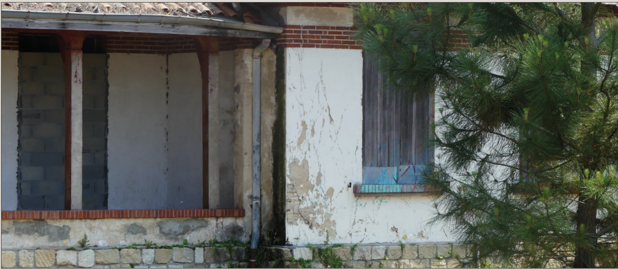
fig.43 - État de délabrement des façades Photographie personnelle.
