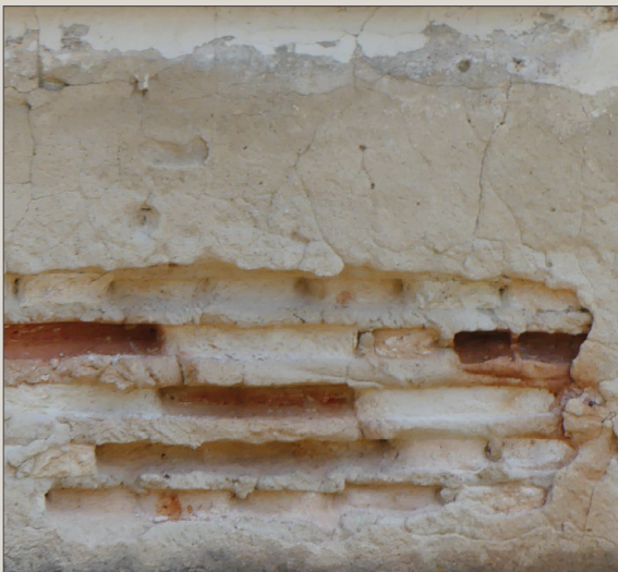
fig.50 - Désordres Photographie personnelle.
