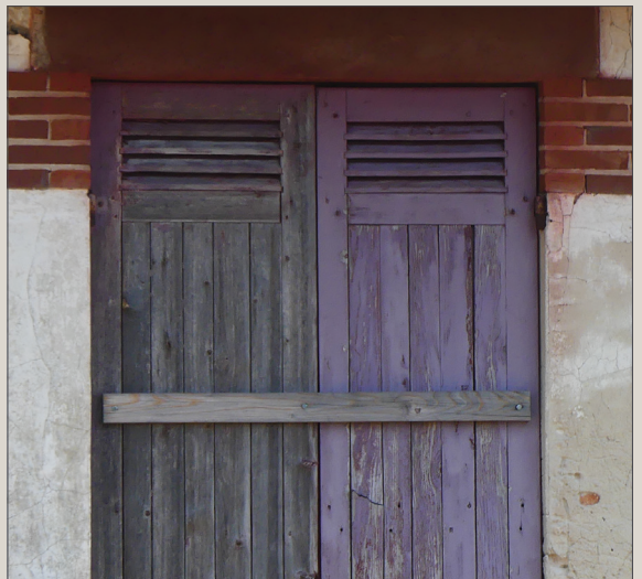
fig.51 - État des volets Photographie personnelle.
