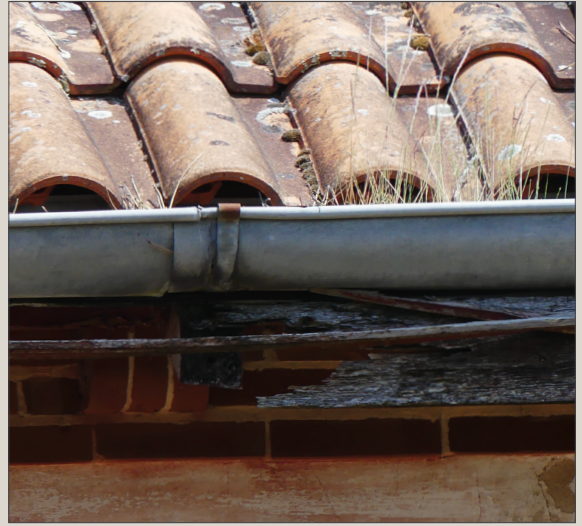
fig.48 - Gouttière obstruée Photographie personnelle.
