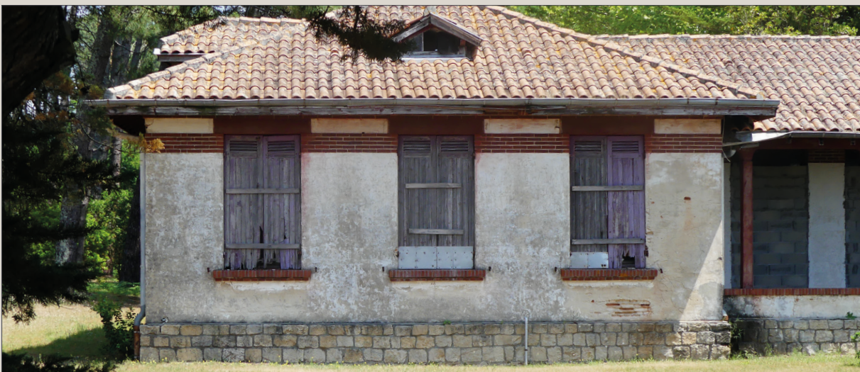
fig.45 - État de délabrement des façades Photographie personnelle.
