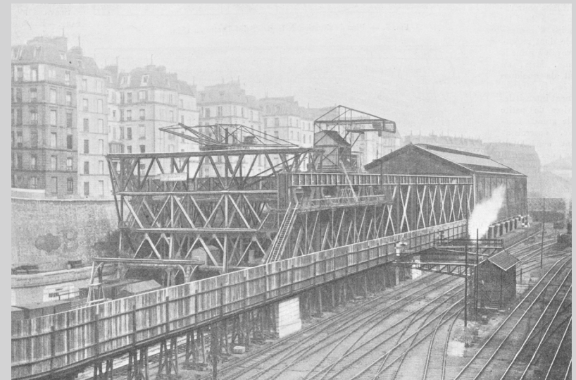
Figure 13 - Chantier de l'extension des Messageries, du côté du boulevard des Batignolles, © Génie civil 1914
