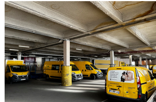
Les camionnettes de La Poste au rdc de la halle de l'Europe
