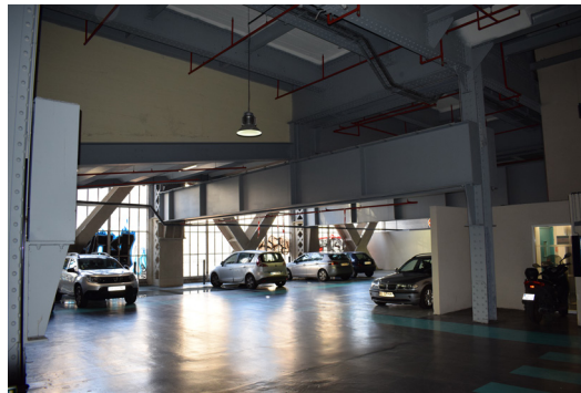
Poutre supportant la rampe d'accès au R-1 de la halle des Batignolles
