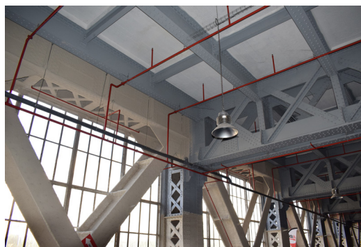
Un système de sprinkler installé dans le parking de la halle des Batignolles
